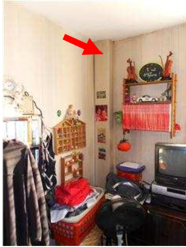
017 - Appartement - Chambre 2 LOT 0101 PH34 : amiante ciment
